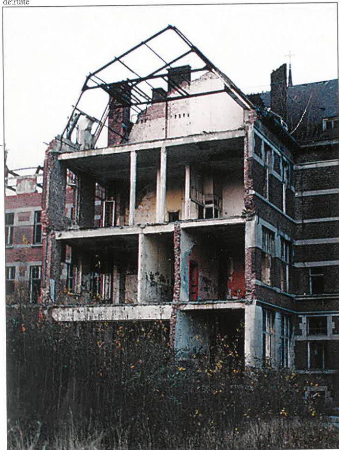
Pour beaucoup l'ancien Couvent était voué à la démolition, mais seule sa façade nord a été détruite
